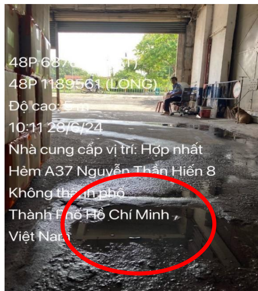
Hình 3.3 Hố ga thu gom đầu nối cuối của hệ thống thoát nước thải
