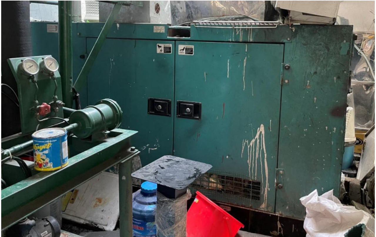
Hình 16. Vị trí hệ thống phát điện dự phòng
